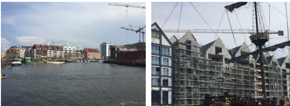
Rysunek 1.2. Dogęszczanie zabudowy śródmiejskiej – inwestycja mixed-use pod nazwą Riverview nad Motławą w Gdańsku (fot. Anna Bernaciak)
